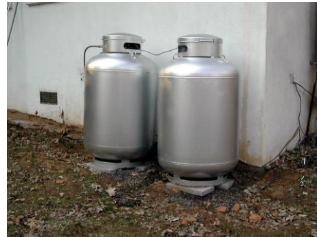
Gaz comprimé bien entreposé : en position verticale, fixé avec des capuchons de sécurité en place et loin du sol humide afin d'éviter toute corrosion.
